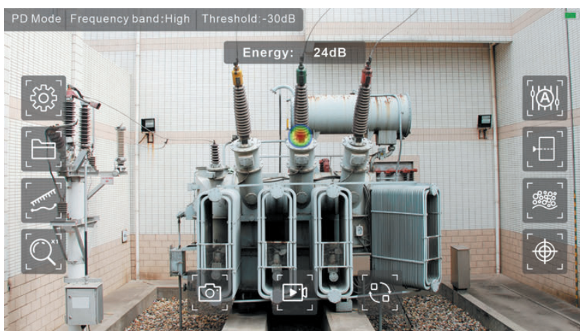
Рис. 4. Пример выявления ЧР на высоковольтном вводе
