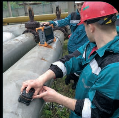
LYFT Картографирование коррозии без снятия изоляции
