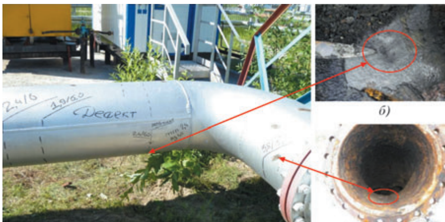
Рис. 14. Низконапорный водовод подтоварной воды КНС-26 Самотлорского месторождения (а), Ø530 мм: ввод в эксплуатацию — 1993 г., диаметр 530×8 мм, протяженность 400 м, сталь 20: б — язвенная коррозия под слоем отложений, остаточная толщина стенки 1,9 мм; в — язвенная коррозия, остаточная толщина стенки 3,9 мм
