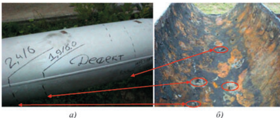
Рис. 10. Низконапорный водовод подтоварной воды КНС-26 Самотлорского месторождения, Ø530×8 мм: а — участок низконапорного водовода подтоварной водой КНС-26 до вырезки катушки; б — язвенная коррозия с остаточной толщиной стенки до 1,9 мм
