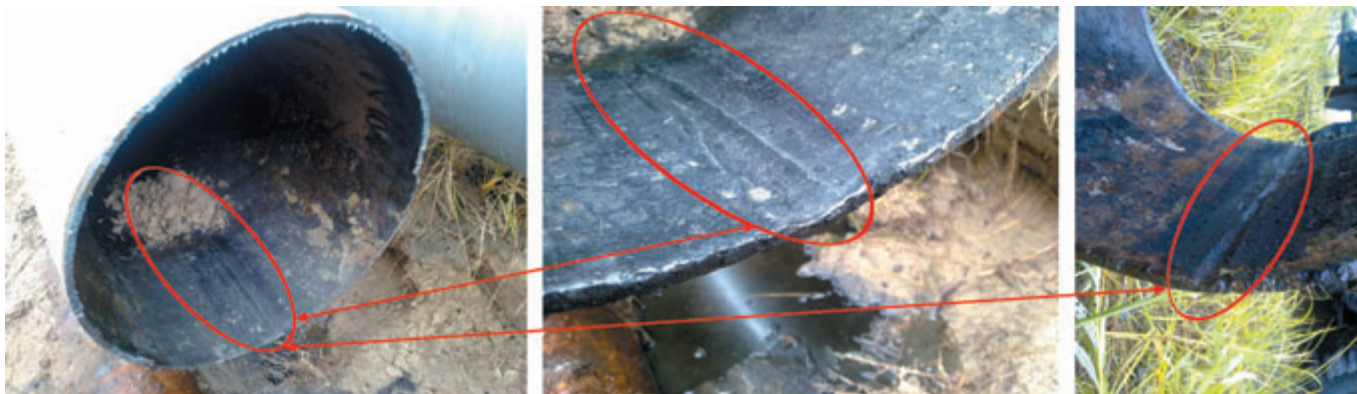
Рис. 11. Трубопровод выхода нефти с первой ступени сепарации до ОГ-200, КСП-10 Самотлорского месторождения, \varnothing 530 \times 10 мм, L = 150 м
