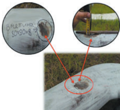
Рис. 13. Водовод выхода подтоварной воды с РВС № 1–4 на насосы некондиционной нефти № 1, 2 КСП-9 Самотлорского месторождения, \varnothing 426 \times 8 мм, L = 20 м
