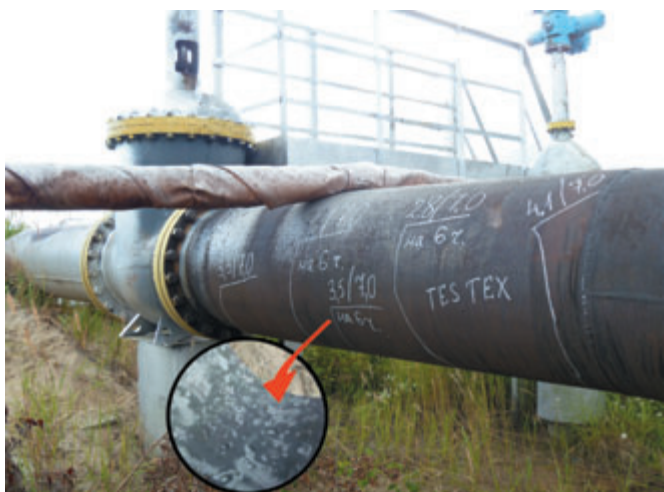
Рис. 12. Газопровод узла давления и учета газа на ГПЗ, КСП-9 Самотлорского месторождения, \varnothing 530 \times 8 мм, L = 150 м
