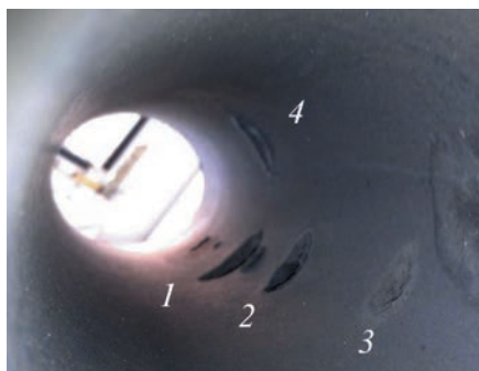
Рис. 9. Результаты визуального осмотра внутренней поверхности образца: 1–4 – дефекты в виде утонений
