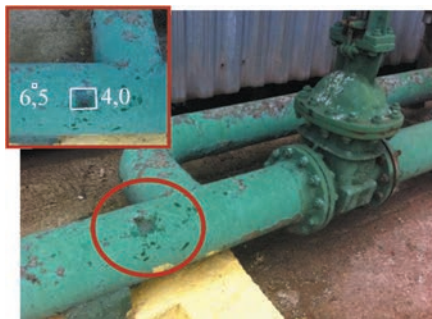
Рис. 5. Дефектный участок трубопровода оборотной воды
