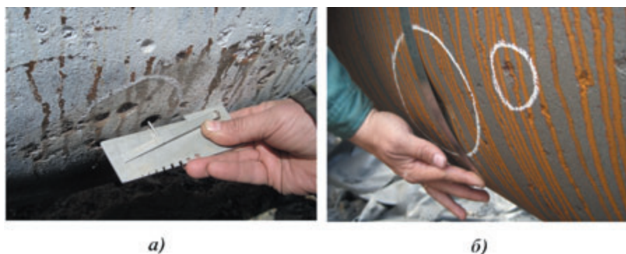
Рис. 5. Дефекты коррозии и механические повреждения трубопроводов: а – язвы; б – вмятина и язвы
